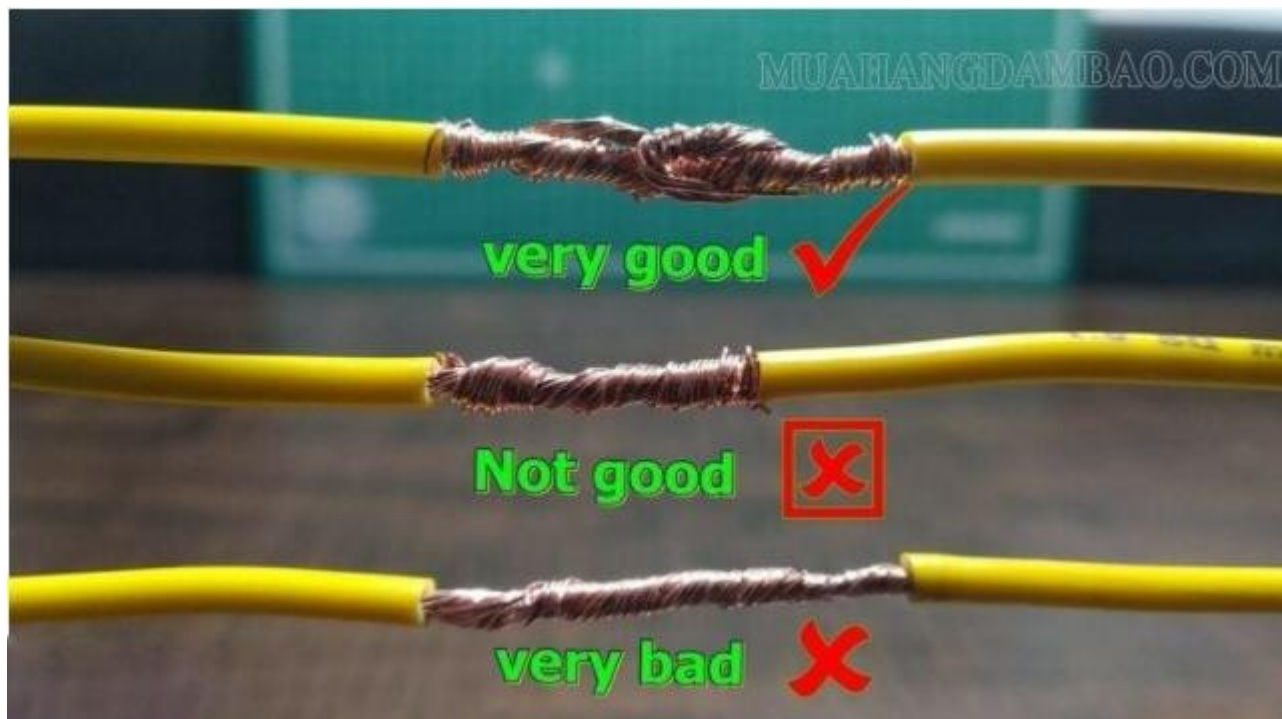
Một mối nối dây dẫn điện đẹp
